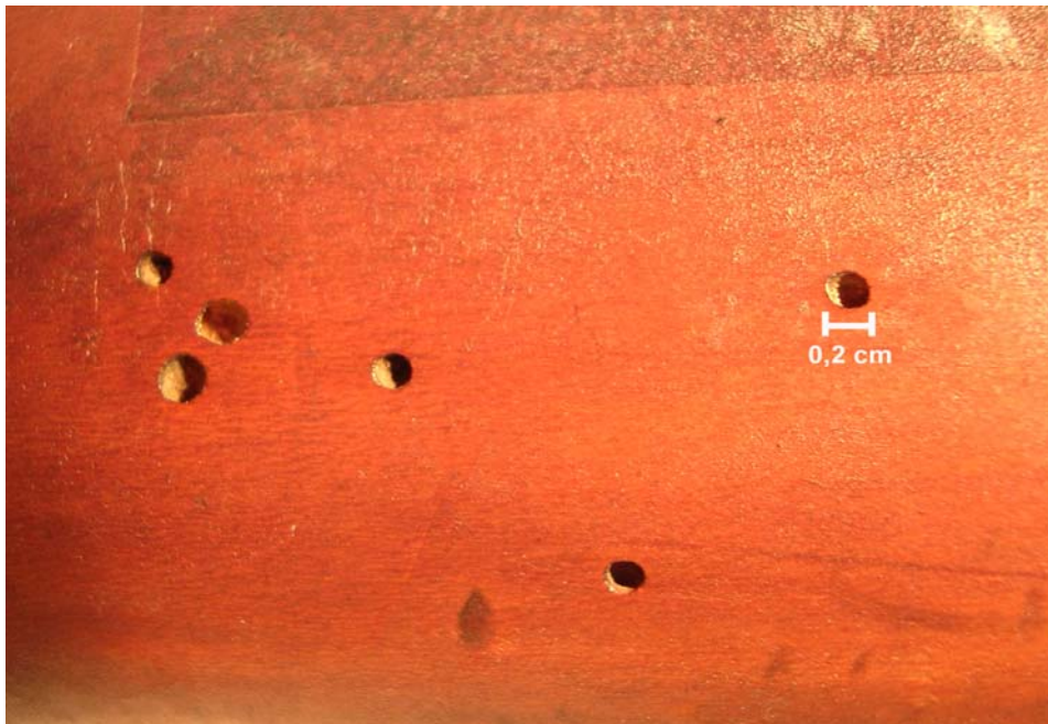
Abbildung 3: Durch Anobienbefall verursachte Ausflugslöcher
